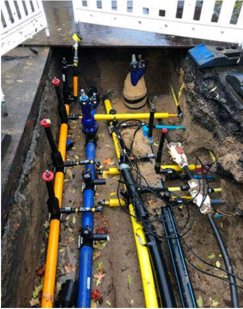
Normalerweise im Untergrund verborgen: blaue Wasserrohre und gelbe Gasleitungen
