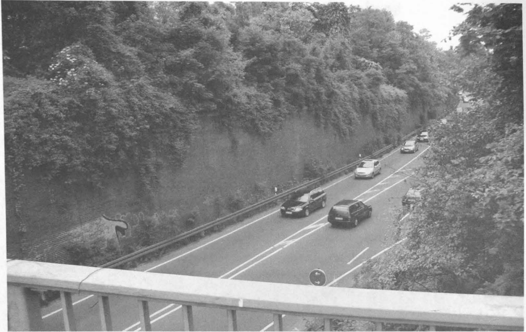
Diese kontinuierlich ansteigende „Mauer“ ist als Zufahrt zur Aachener Straße konzipiert und könnte nun in Betrieb genommen werden.
